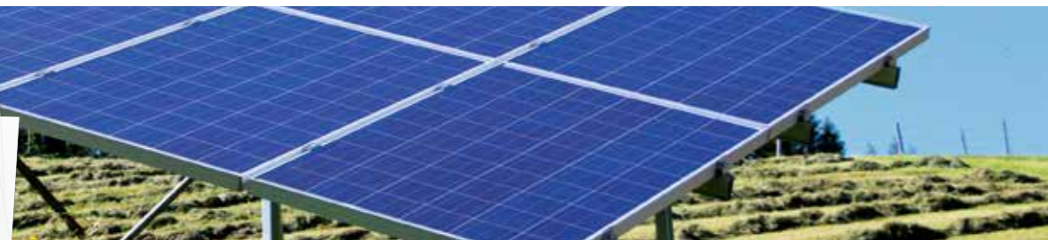
Foto 7: Dezentrale Stromerzeugung mithilfe von Agrophotovoltaik (H.-M. Zademach)
